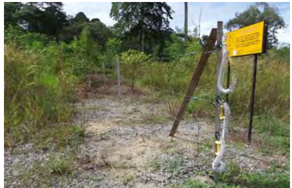
Pagar lencongan elektrik A-PL1
