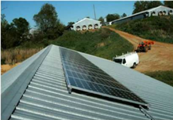
Panel solar yang diletakkan di atas reban ayam tertutup
