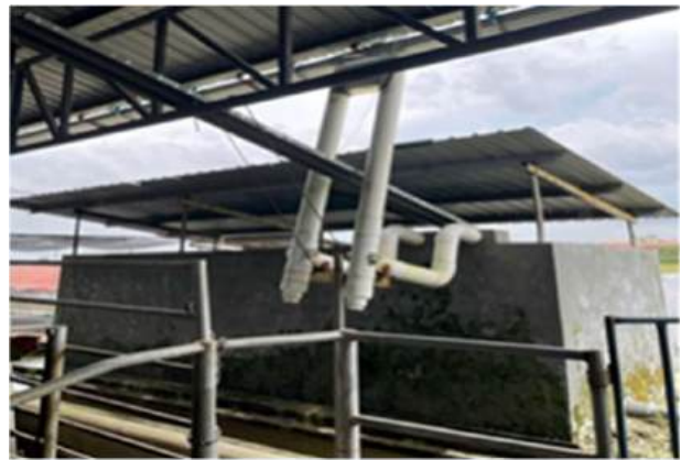
Tangki takungan air hujan
