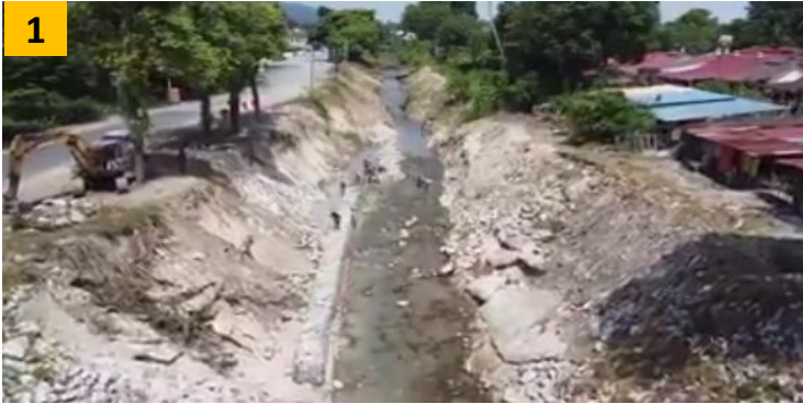
1 Kejadian hakisan tebing sungai pada tahun 2020 akibat hujan lebat
